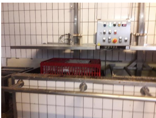
Abbildung 2: Hubwerke der Gasbetäubungsanlage für Geflügel (Bildbeschreibung: Hubwerk links mit Geflügelkiste, rechts leer), © tierschutzkonform.at
